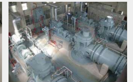
某排水機場 排水ポンプ設備
