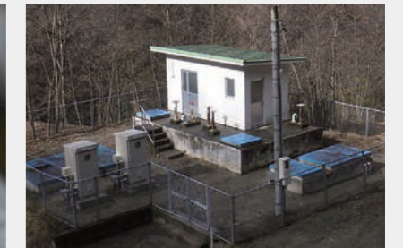
某上水道施設 浄水設備
