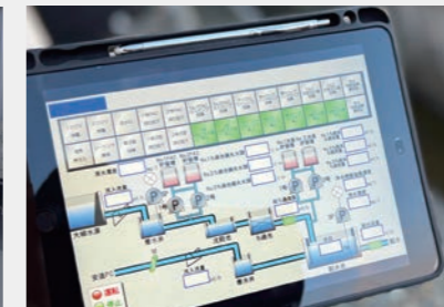
某上水道施設 クラウド監視設備
